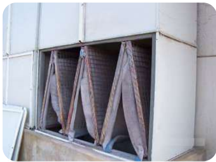
Zona de ubicación de filtros de cabinas de pintura
