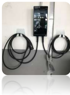
Punto de carga de vehículos enchufables
